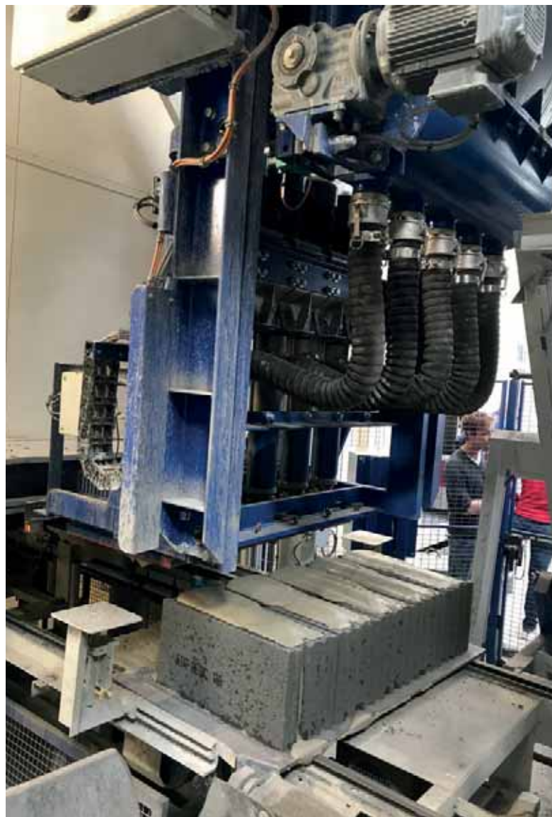
Sistema de dosificación de espuma mineral.
