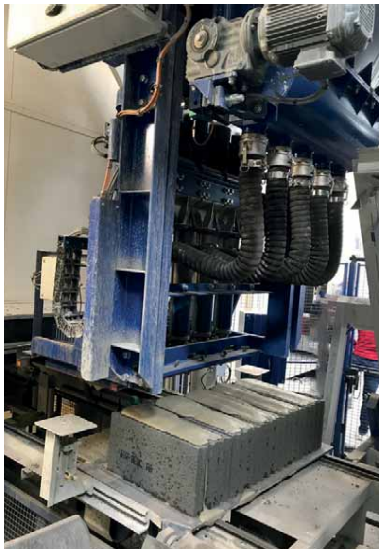
Les modules de fabrication et de dosage de la mousse ont été intégrés dans la ligne de production existante, directement en sortie presse.
