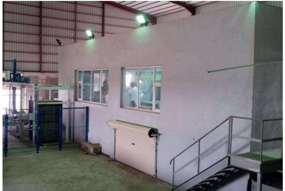
La instalación completa es supervisada por un único operador, que se encuentra en la sala de control de máquinas en el centro de la instalación.
